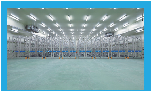
冷凍室A 電動式移動パレットラック
