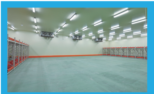
冷凍室B プッシュバックラック
